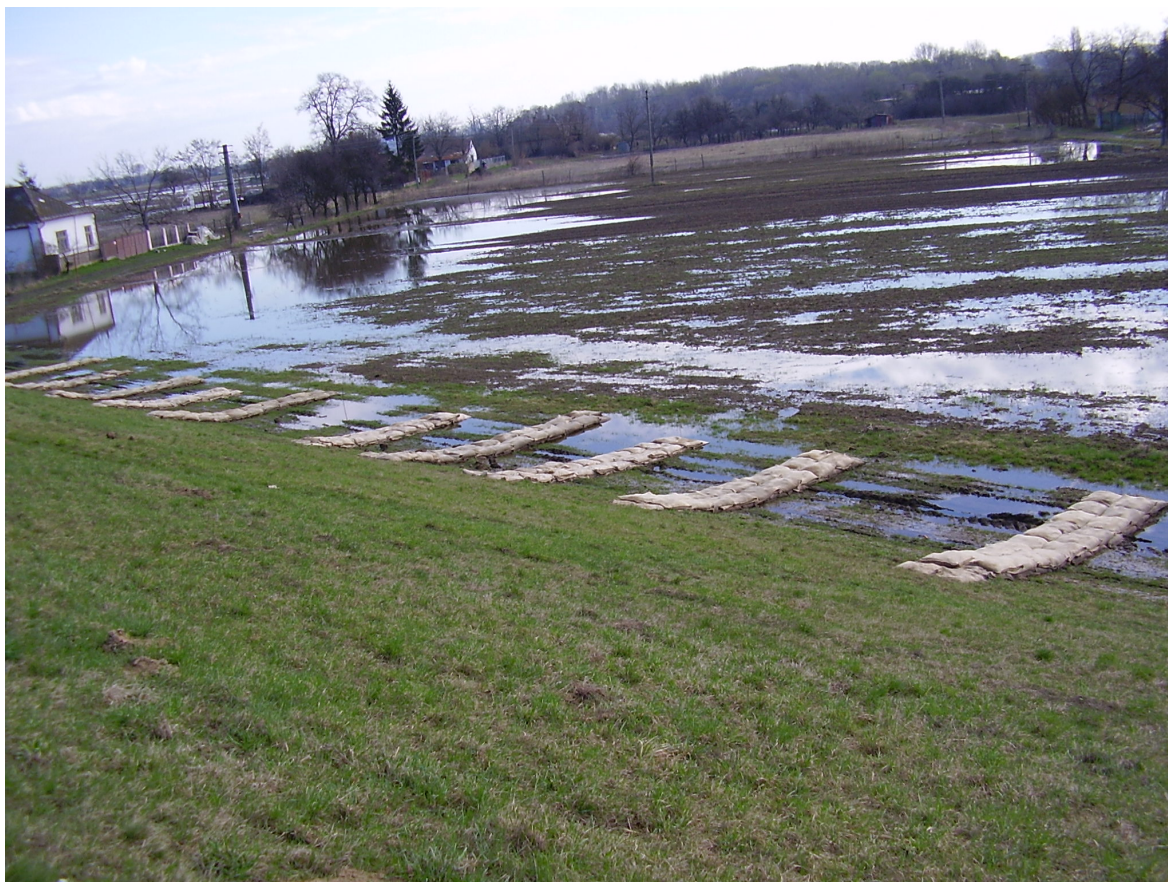
Obr. 1: situácia na vzdušnej strane hrádze počas povodňového stavu v roku 2006.
