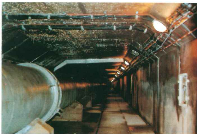
Komunikačná chodba a prírodné potrubie na úpravňu
