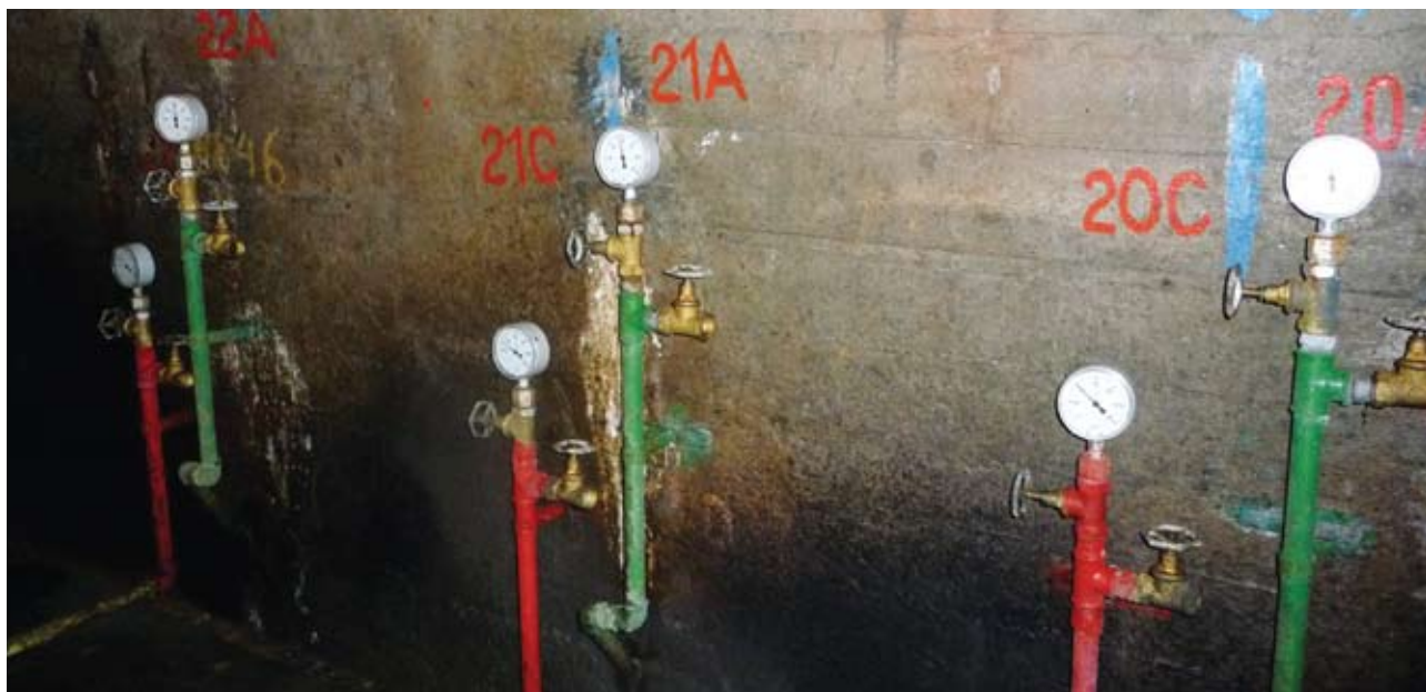
Meracie zariadenia na vodárenskej nádrži Hriňová
