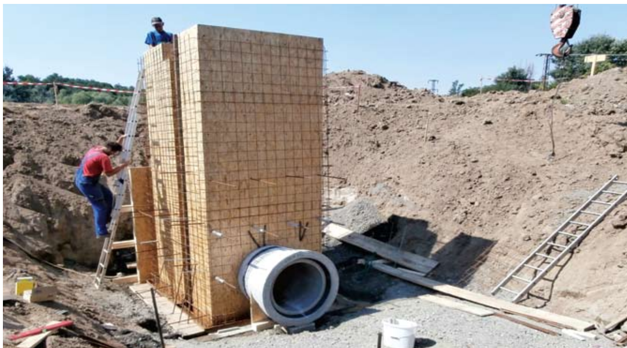
Sfunkčňovanie hrádzového priepustu vo Vyškovciach nad Ipľom
