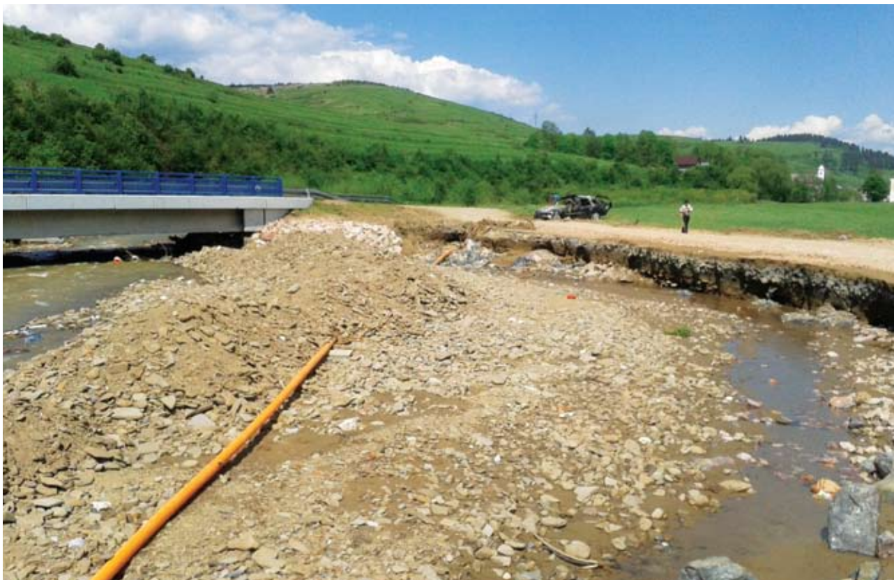
Jurské-výmoľ pri cestnom moste ponad Holumnický potok - obnažený plynovod
