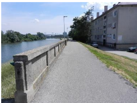
Obr.22 Zameranie L'OH Hlohovec, vrátane vybudovaného ochranného múru. V tomto prípade sa vybreženie modelovanej hladiny Q100 nepotvrdilo.
